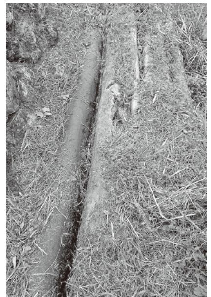
老朽化した水路
