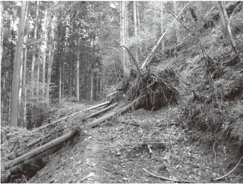
早急な災害復旧がのぞまれる作業道
